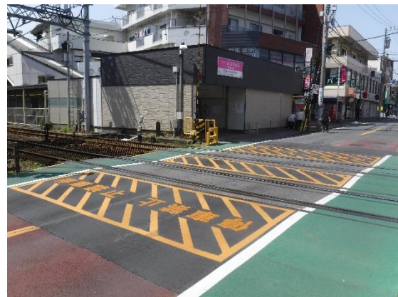
みのり台1号踏切道の注意喚起表示
