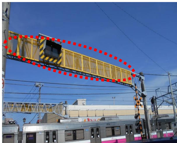
大型踏切警報機
