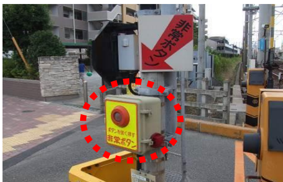
支障報知装置
