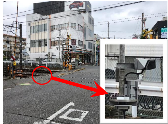
踏切障害物検知装置（鎌ヶ谷大仏3号踏切道）
