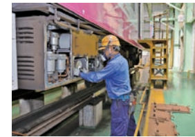
コンプレッサーの点検 (月検査)
